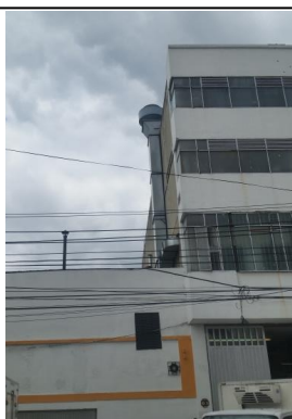
FOTOGRAFÍA 7. DUCTO DE DESFOGUE
