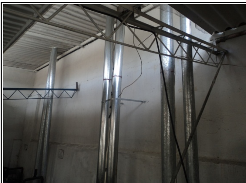
FOTOGRAFÍA 5. DUCTOS DE LOS HORNOS
